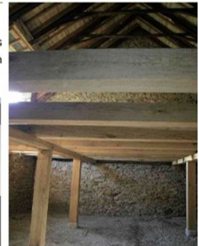
Grange communale, poteaux et solivage refaits à l'identique (chantier 2009 à Lapleau, P. Rossignol, architecte)
